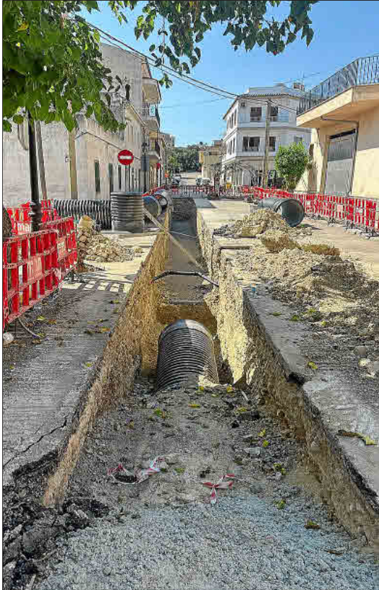
Los vecinos sufrían inundaciones en sus casas antes de las obras.
